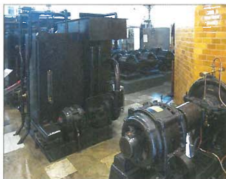
Bild 3: Flüssigkeitswiderstand (Hydrorheostat, links) und Kühlwasserpumpe
