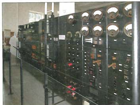
Bild 4: Die komplette Anlage, hier die Hauptschalttafel, ist gut gepflegt.
