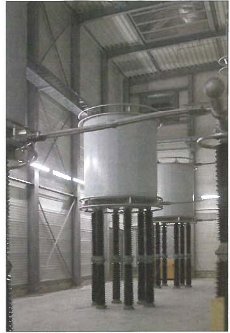
Bild 5: Als Luftdrosseln ausgeführte Glättungsdrosseln in der Stromrichterhalle
