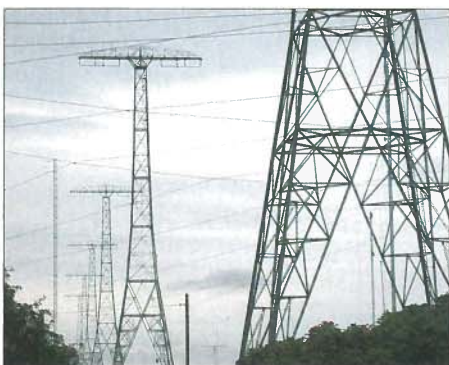
Bild 2: Die 127 m hohen Masten tragen die Antennendrähte.
