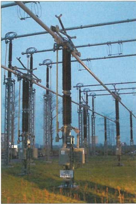
Bild 3: Motorisch betriebene Scherentrenner in der 380-kV-Schaltanlage; während der Führung wurde dieser hochgefahren.
