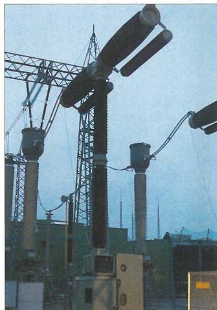
Bild 2: Leistungsschalter für 380 kV; der auf einem Isolator montierte „Top“ beinhaltet einen 380-kV-Stromwandler.
